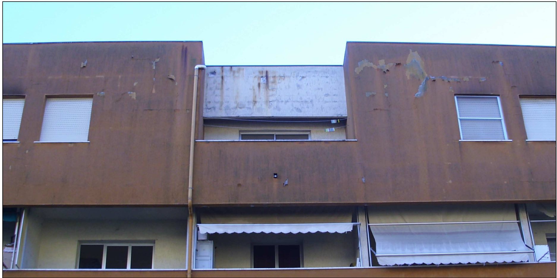
Particolare facciata da ripristinare
