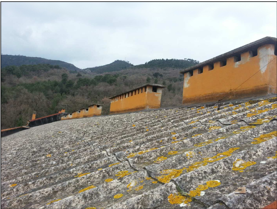
Particolare lastre cemento amianto esistenti da smaltire
