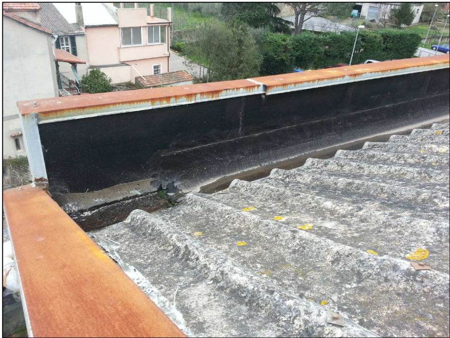
Particolare lastre cemento amianto esistenti da smaltire
